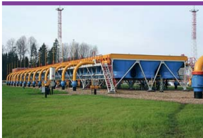
Air coolers AVG-85MG (Kursk Compressor Station)
